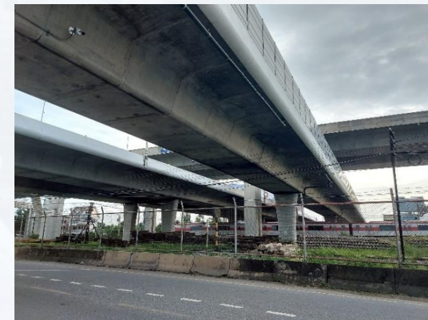
รูปแบบโครงสร้างคานคอนกรีตอัดแรงรูปกล่อง (Concrete Box Segmental)
